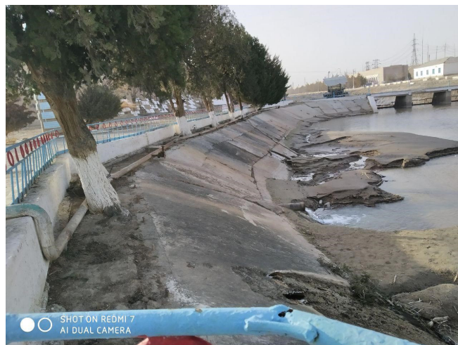
Рис. 1. – Деформация и заиливание подводящих каналов и аванкамер НС.
