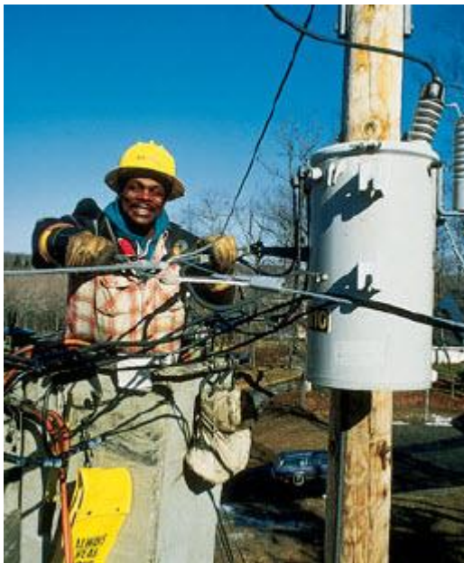
7-7 Расм. Сим ёғочдаги пасайтирувчи трансформатор
