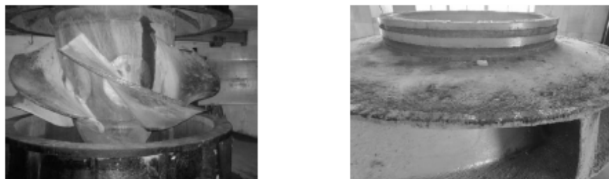
Рисунок 3 – Состояние рабочих колес осевых насосов Каршинского магистрального канала и центробежных Аму-Бухарского машинного канала из-за абразивного и кавитационного износа лопастей (автор фото НИИИВП)
