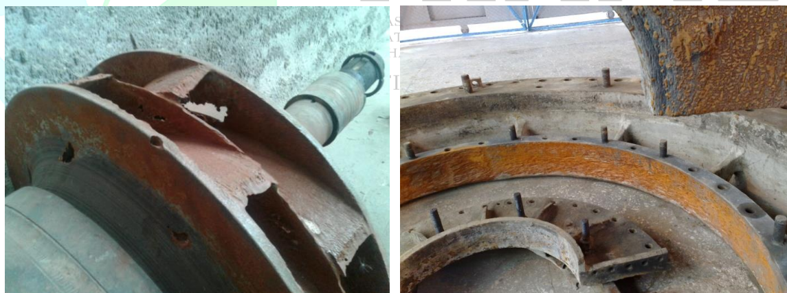
Рис.1 Износ рабочего оборудования НС «Чархин»
