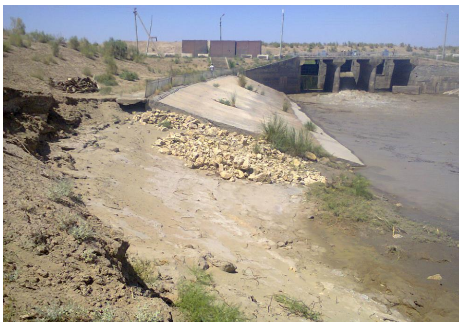
3.11-rasm . Avariya suv tashlash kanali darvozasi
