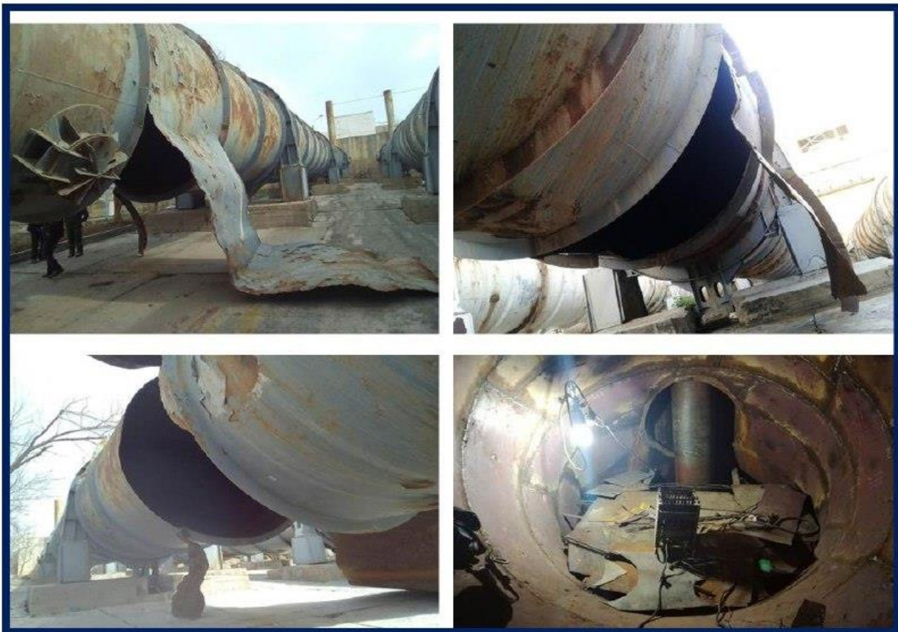
6.8-rasm. Bosimli quvurlarda sodir bo‘lgan yorilishlar.
