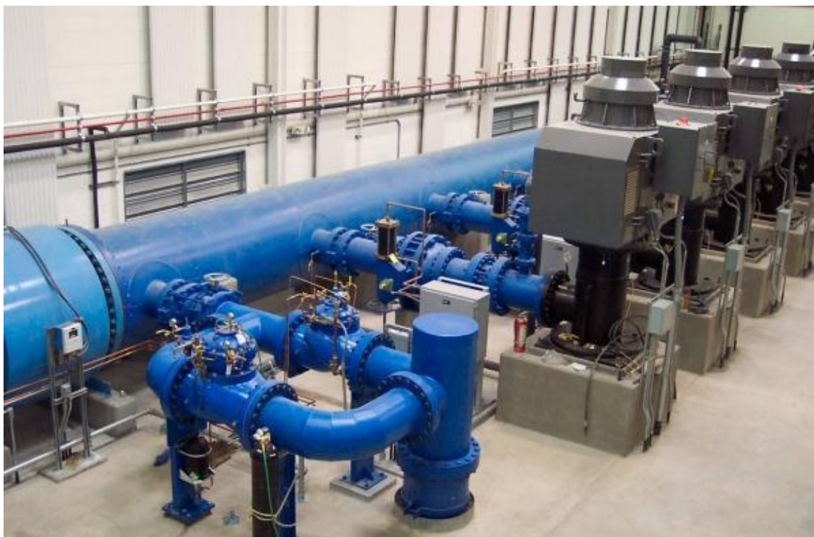
13.11-rasm. Avtomatlashtirilgan nasos stantsiyasining umumiy ko‘rinishi.
