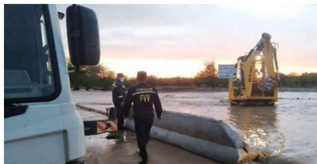
Рис.3. В Сырдаринской области прорвало дамбу Сардобинского водохранилища.
