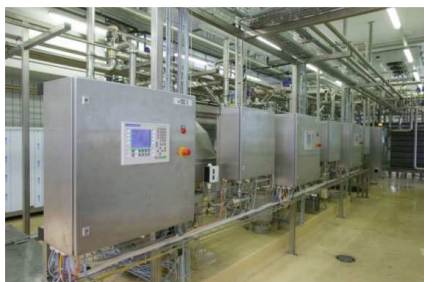
Рис. 2. Шкафы ввода/вывода с вмонтированными операторскими панелями.
