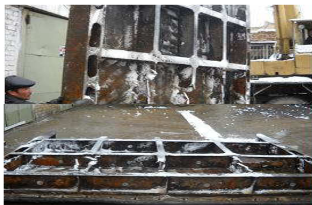
3-расм. Гидротехника иншоотлари затворларини нотекис коррозияланиши.
