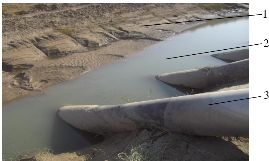
15.1-rasm. Qorovulbozor nasos stansiyasida suv olib keluvchi kanalning loyqaga to'lib qolgan holati. 1- loyqaga to'lgan kanal; 2-kanaldagi suv; 3-nasosning so'ruvchi quvuri.
