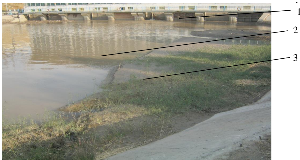
15.2-rasm. Amu-Buxoro-1 nasos stansiyasi avankamerasining loyqaga to'lib qolishi. 1-nasosga suv kirish yo'li; 2- avankameradagi suv; 3-avankameraga cho'kkan loyqa.
