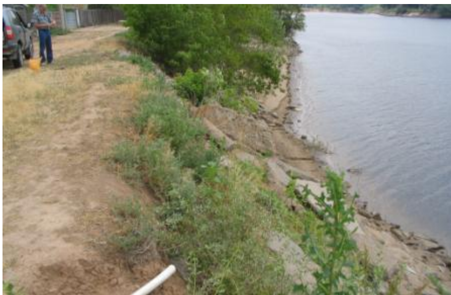
Фото 3. Разрушение ограждающей дамбы
