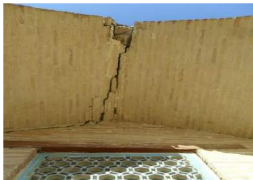
Фото 2. Сквозные трещины на втором
