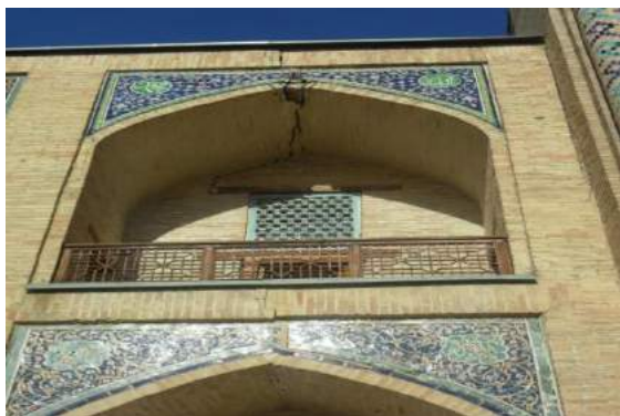
Фото 3. Фрагмент трещины этаже (западная часть фасада – первые худжры)
