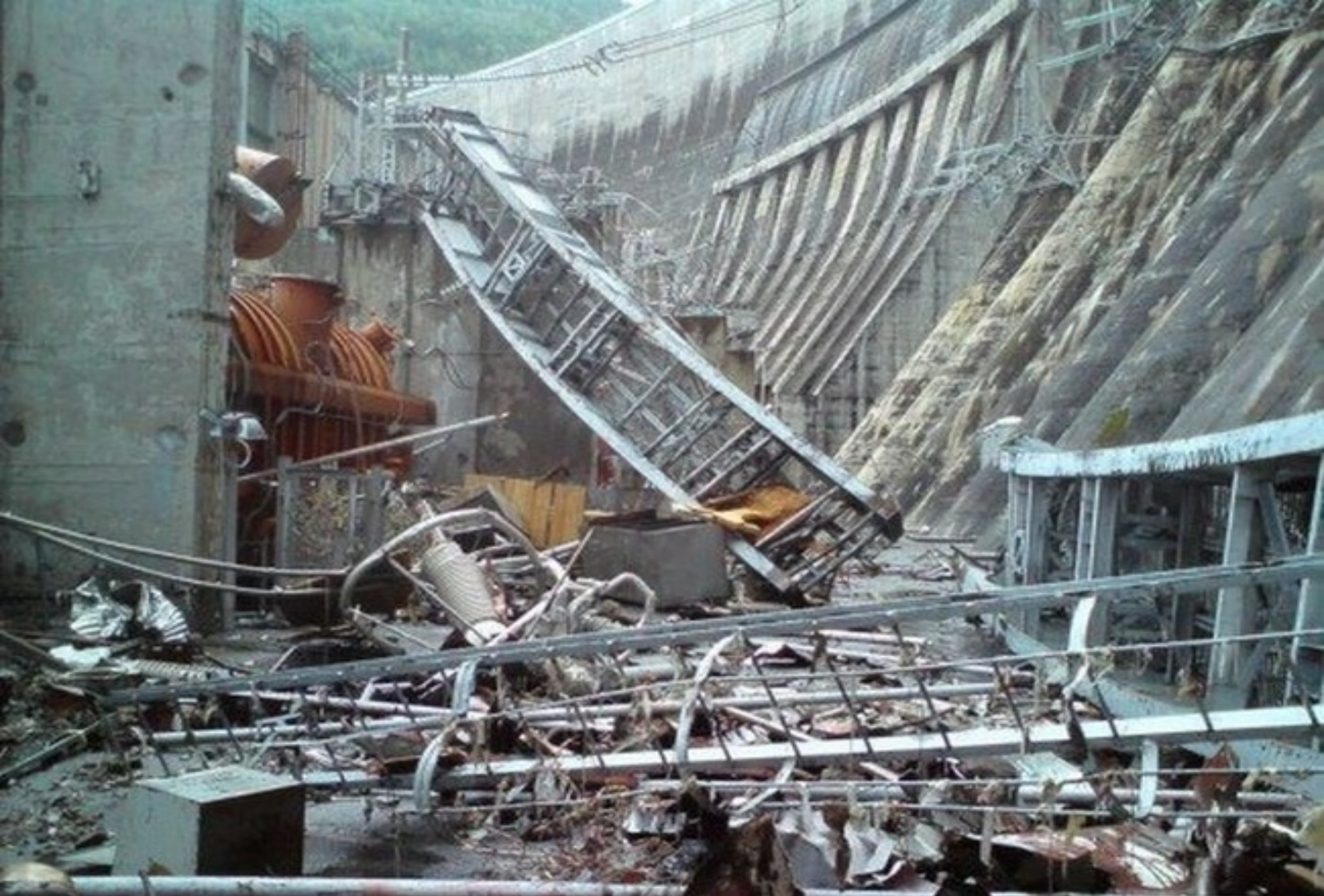
Саяно-Шушенск ГЭС-даги авария
