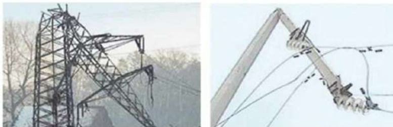
Рис. 1. Последствия гололёда для линий электропередач
