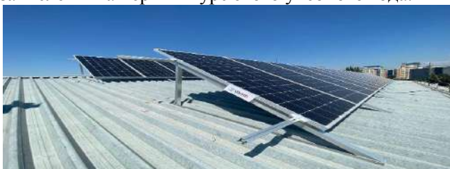
Рис. 2. Солнечная электрическая станция с мощностью 10 кВт, установленная на крыше корпуса «А» Алматинского университета энергетики и связи
