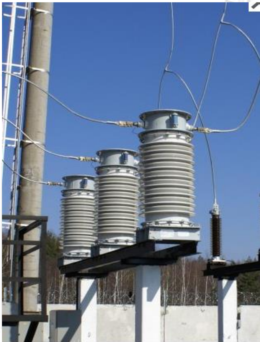
Ток трансформатори (110 кВ)
