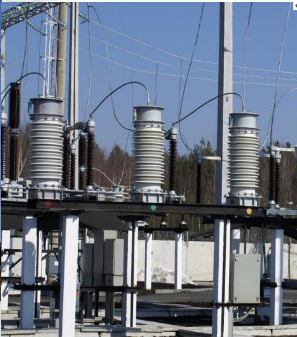
Кучланиш трансформатори (110 кВ)
