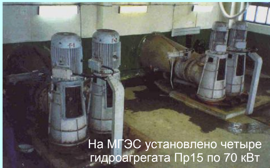
Лукомльская МГЭС, Белоруссия Станция введена в эксплуатацию в 2000 г.
