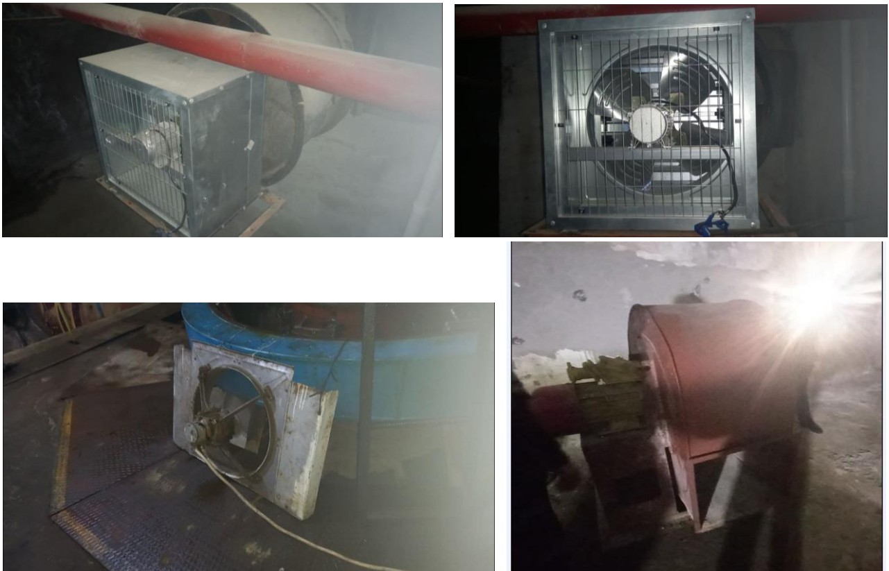
Рисунок 1.5. Вентиляционные установки в помещениях насосной станции.
