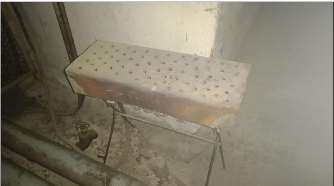
Рисунок 1.6. Нагревательная установка в помещении электродвигателя.
