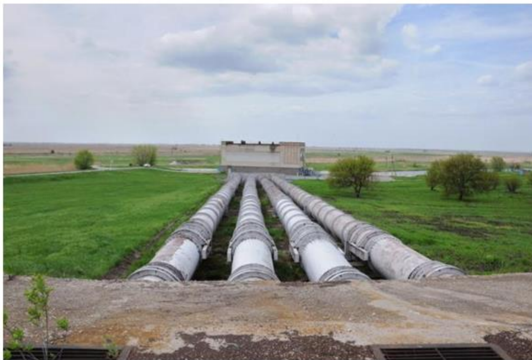
Рисунок 1.1. Подъёмные трубопроводы насосной станции.
