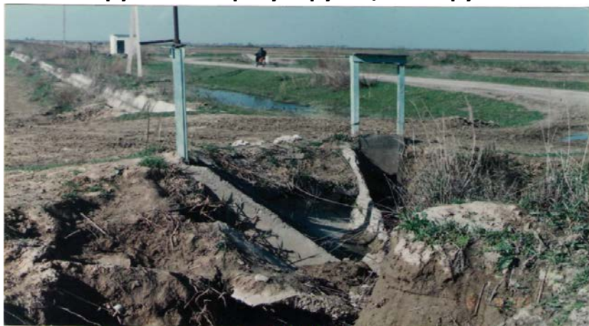
Разрушенные регулирующие сооружения
