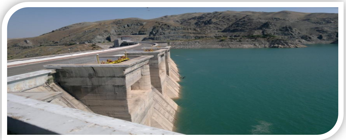
3.9-rasm. Suv omboridagi betonli to‘g‘on
