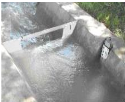
Рис.1. Волосли Чиполетти (вид с верхнего бьефа): водослив ВЧ-50; 2 - ребро жесткости; 3-успокоительная наивысмерной рейкой.
