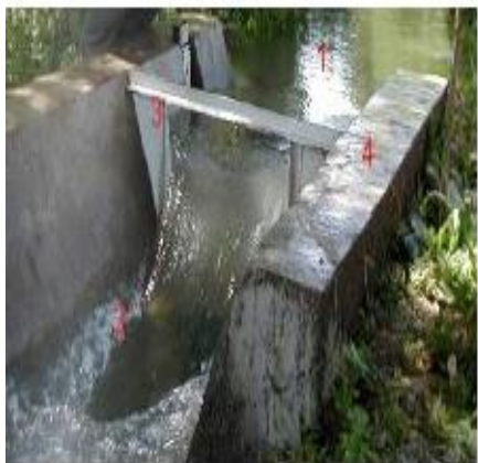
Рис.2. Волосли Чиполетти (вид с нижнего бьефа): подводящий участок; 2 - отводящий участок; 3 - водослив; крепление бермы.
