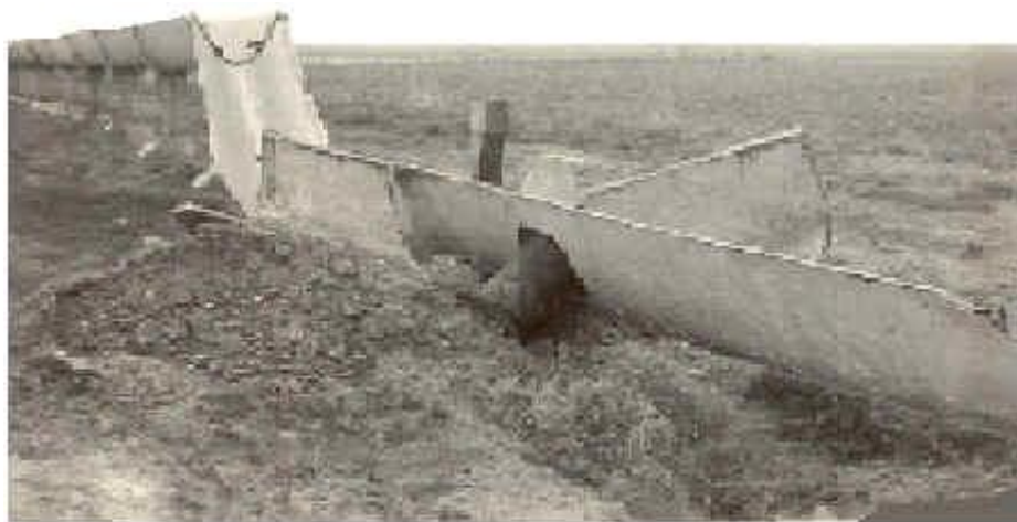
43-rasm. Beton arikchalari tizimining suffoziya natijasida buzilishi (Buxoro viloyati)
