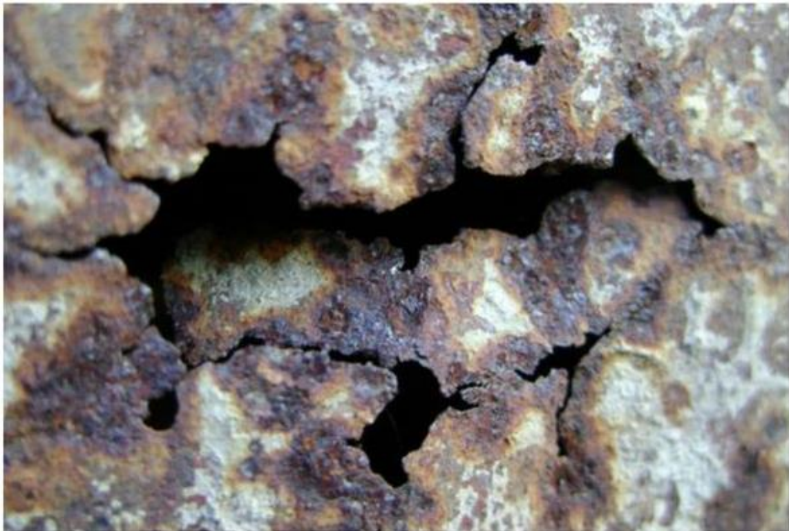
97-rasm. Korroziyadan yorilish (emirilish)
