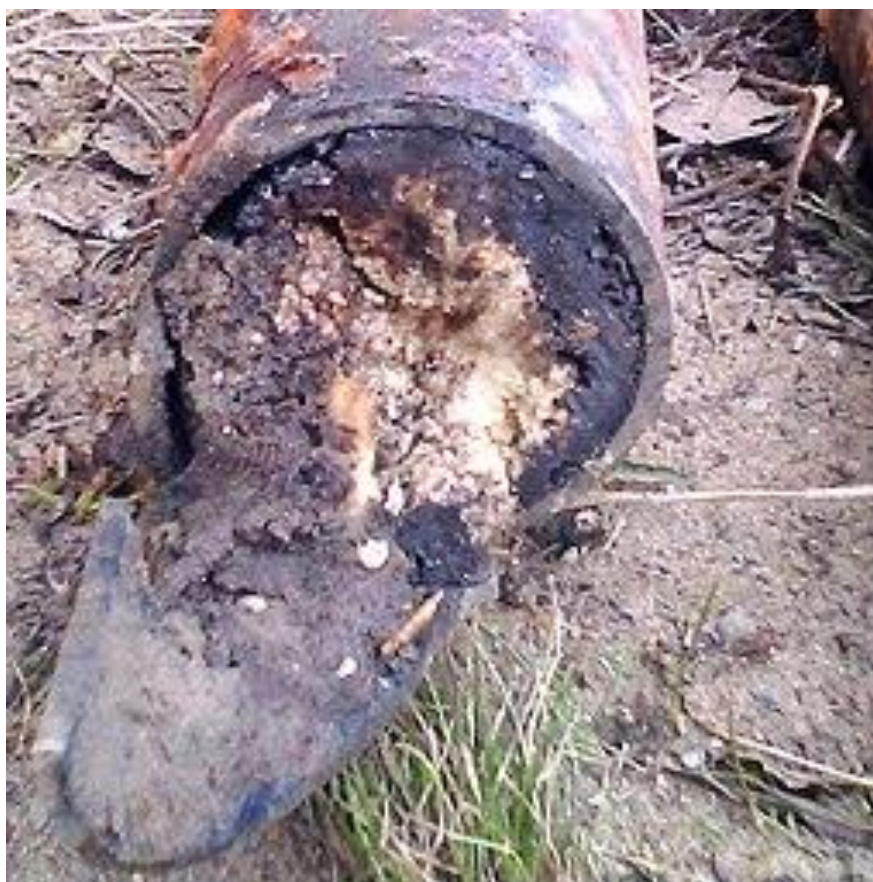
Рис. 5.4. Чугунная труба через 40 лет эксплуатации
