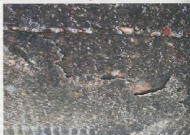
Рис.2. Разрушение защитного слоя бетона, правой части лотка, площадь разрушения 20x15 см
