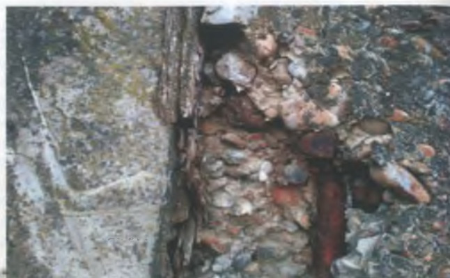
Рис.1. Оголение арматуры от потери защитного слоя бетона правой боковой стенки водосброса Туябугузского водохранилища
