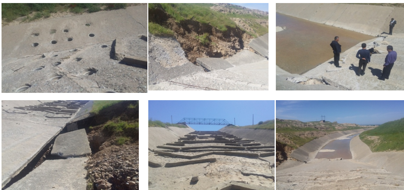
3-расм. Лангар сел-сув омборининг сув ташлама иншоотини сел оқимининг келиши оқибатида шикастланишлари
