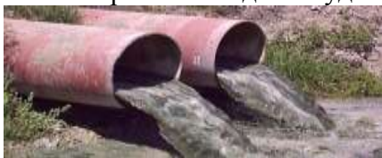
Рис.1 Сброс сточных вод
