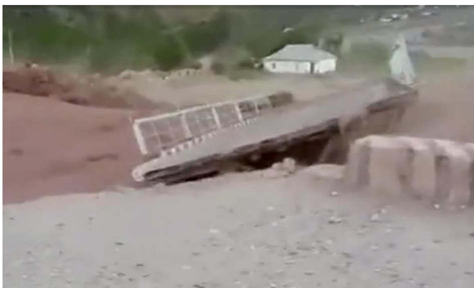
Рис. 3.7. Фотография разрушенного моста
