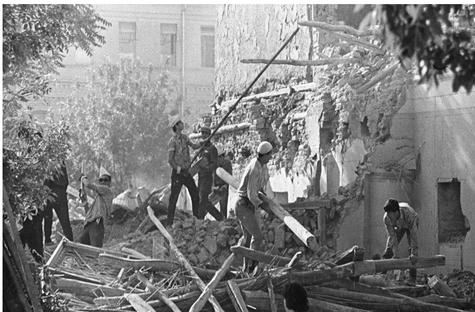
Рис. 3.16. Фотографии повреждений при Ташкентском землетрясении (1966 г.)
