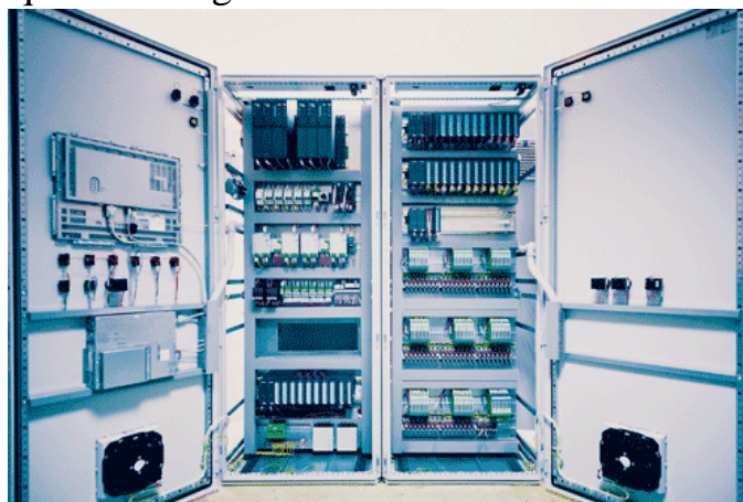
3.11-rasm. Simatic S7-414H/417H kontroller bilan quyi tizim manbasini shkafda joylashuvi keltirilgan
