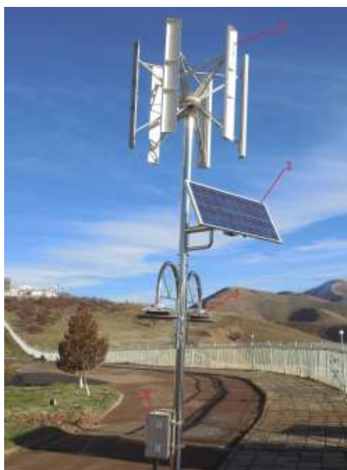
Рис.3. Фото гибридной установки института Материаловедения НПО «Физика-солнце» АН РУз мощностью 300 Вт. 1-ветрогенератор вертикальной осью, 2- фотоэлектрический панель, 3-осветительные лампы, 4- аккумуляторная батарея.
