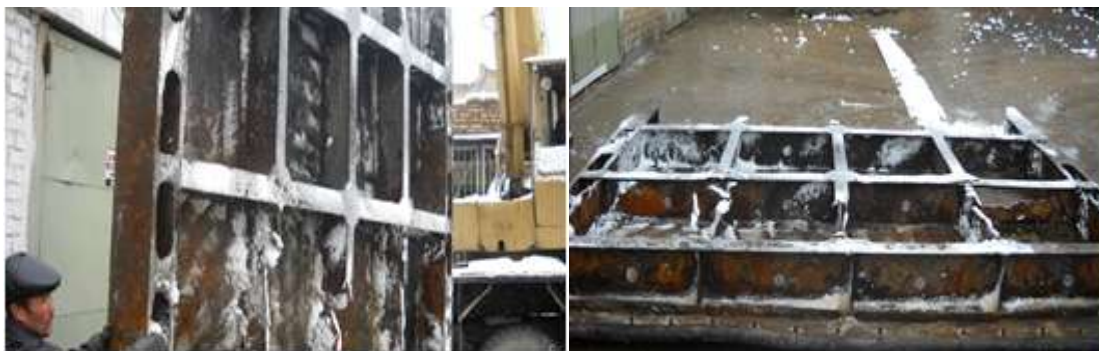
3-расм. Гидротехника иншоотлари затворларининг нотекис коррозияланиши.
