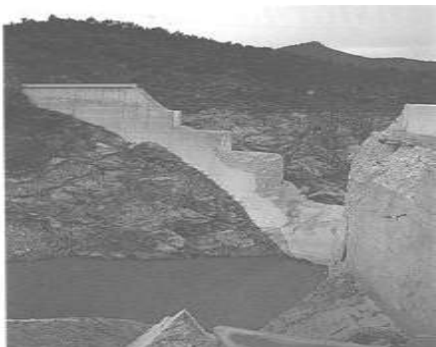
Разрушенная плотина Мальпассе (Франция)
