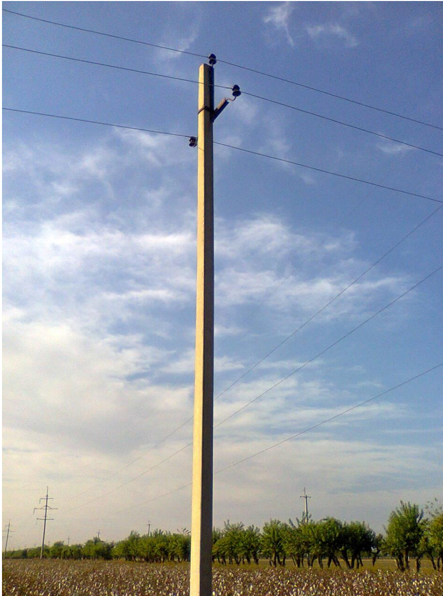
Kuchlanishi 10 kV li havo liniyasi
