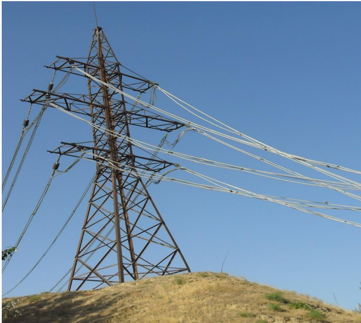
4.10-rasm. Kuchlanishi 6 kV li A300 markali elektr tarmog‘ining umumiy ko‘rinishi
