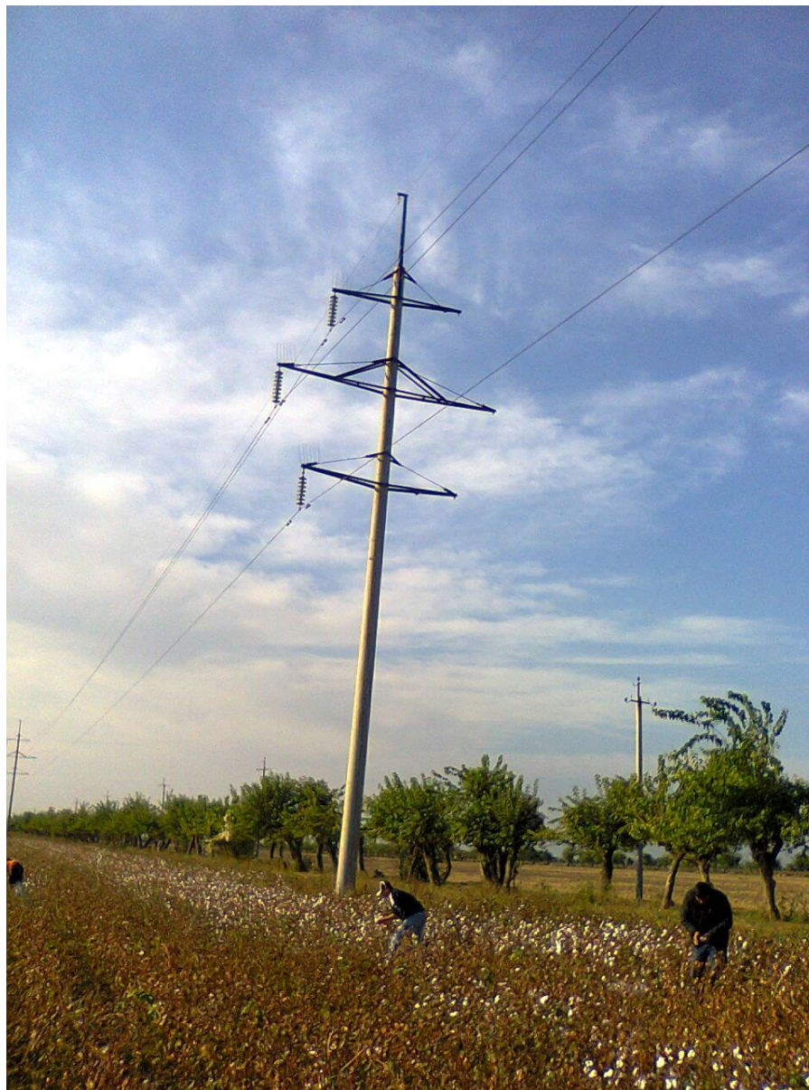
Kuchlanishi 35 kV li havo liniyasi
