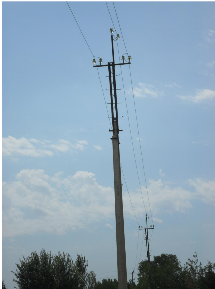
4.21- rasm. Kuchlanishi 10 kV li o‘tuvchi sim ustunning umumiy ko‘rinishi
