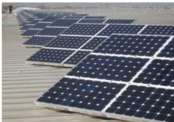
Фотоэлектрическая станция мощностью 10 кВт Самаркандской области
