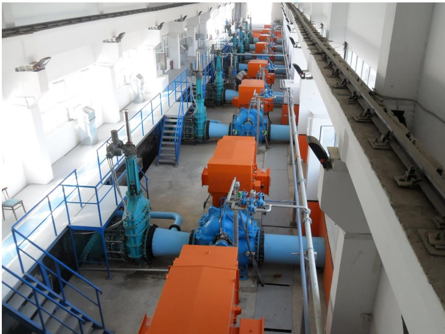
2.2-rasm. Quvvati 850 kVt li elektr dvigatel bilan jihozlangan sug'orish nasos stansiyasi
