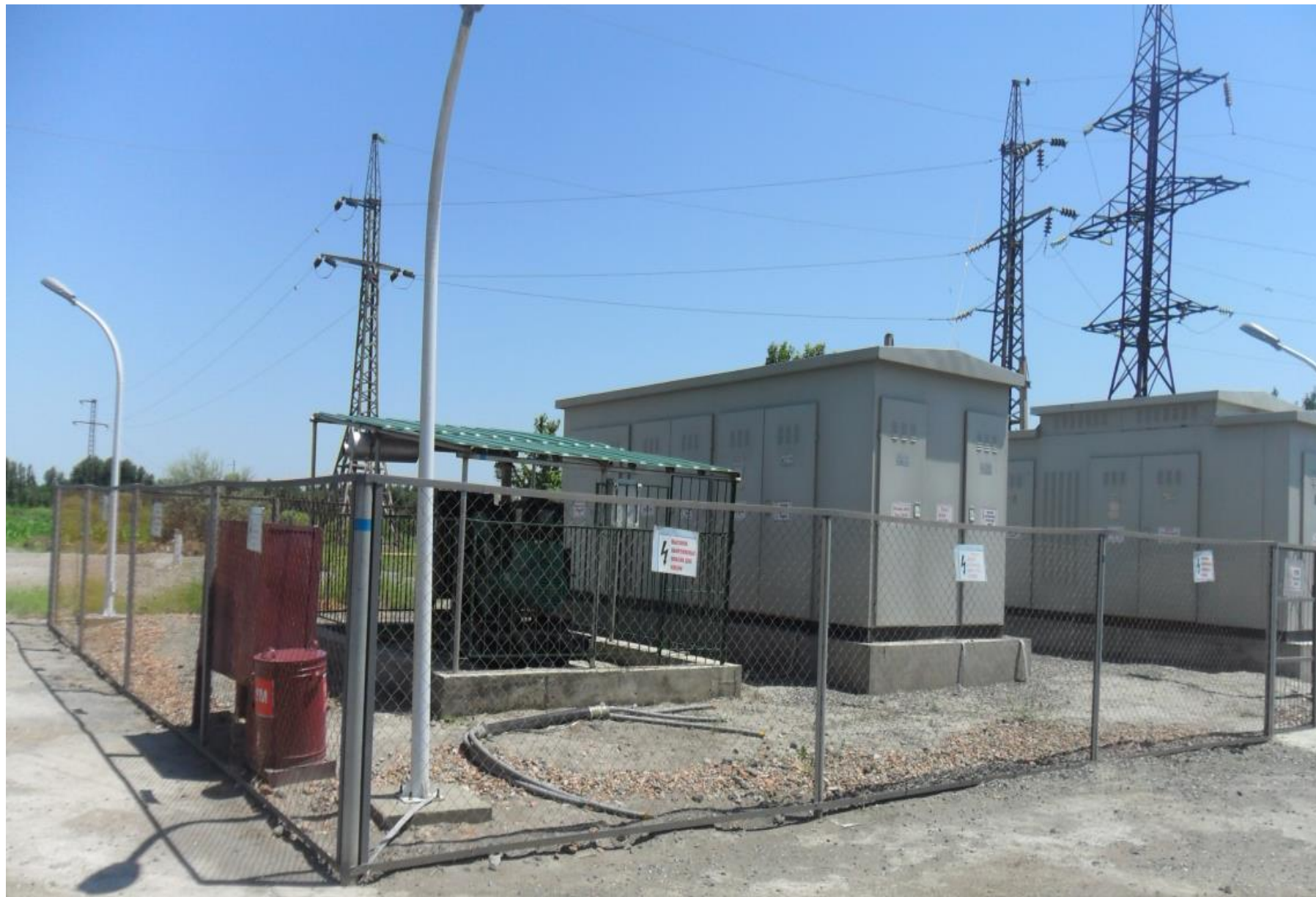
5-rasm. Kuchlanishi 35/10 kV li podstansiyaning umumiy ko'rinishi
