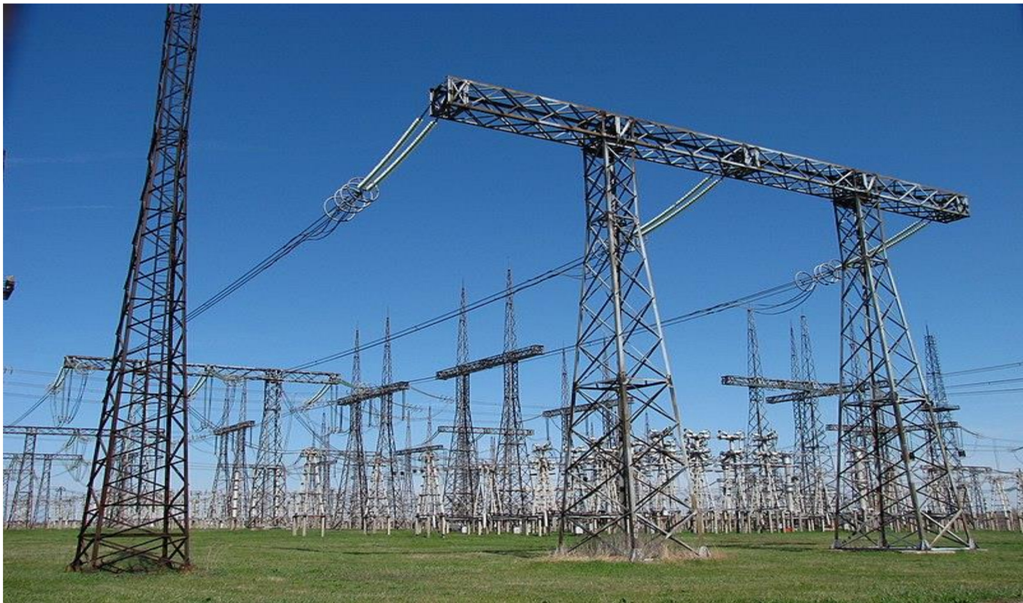
Kuchlanishi 750 kV li ochiq tarqatish qurilmasi (OTQ)
