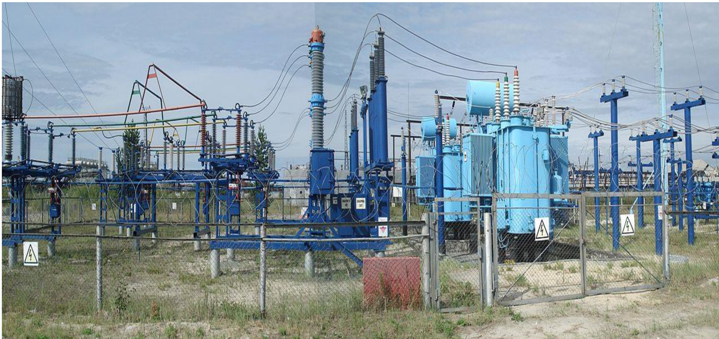
Kuchlanishi 110 kV li transformator podstansiyasining ochiq tarqatish qurilmasi (OTQ)
