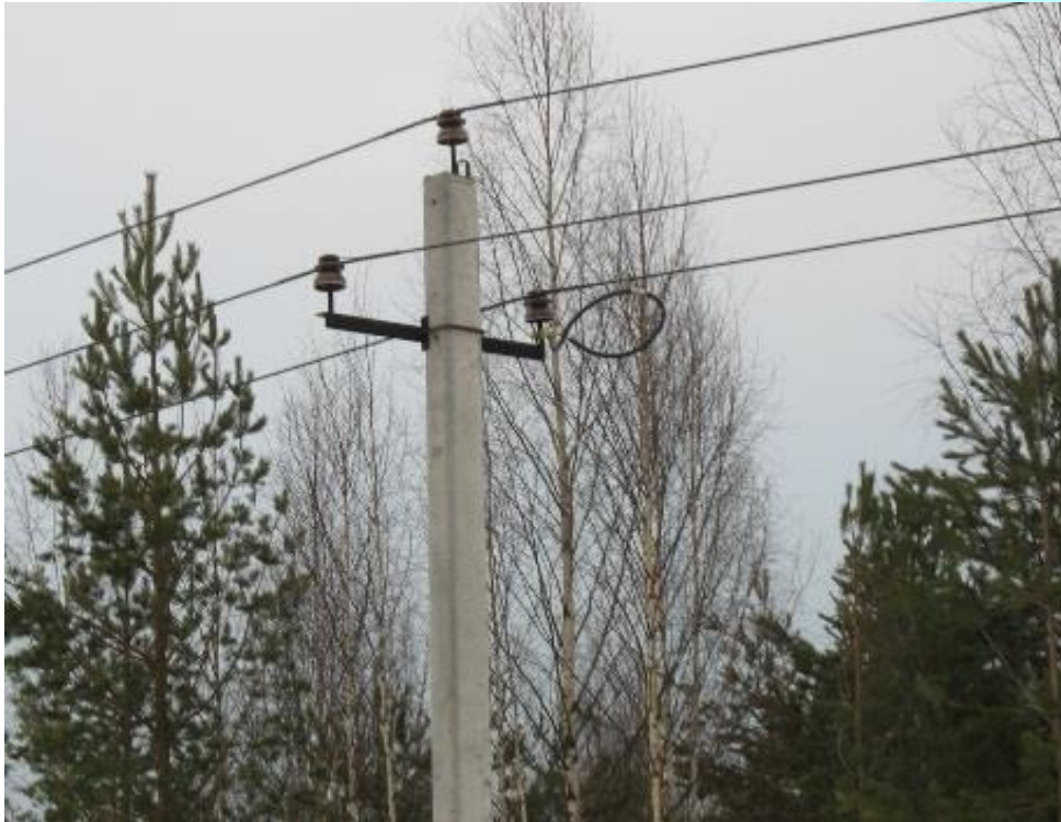
10 (6) kV li temir-beton sim ustunli
