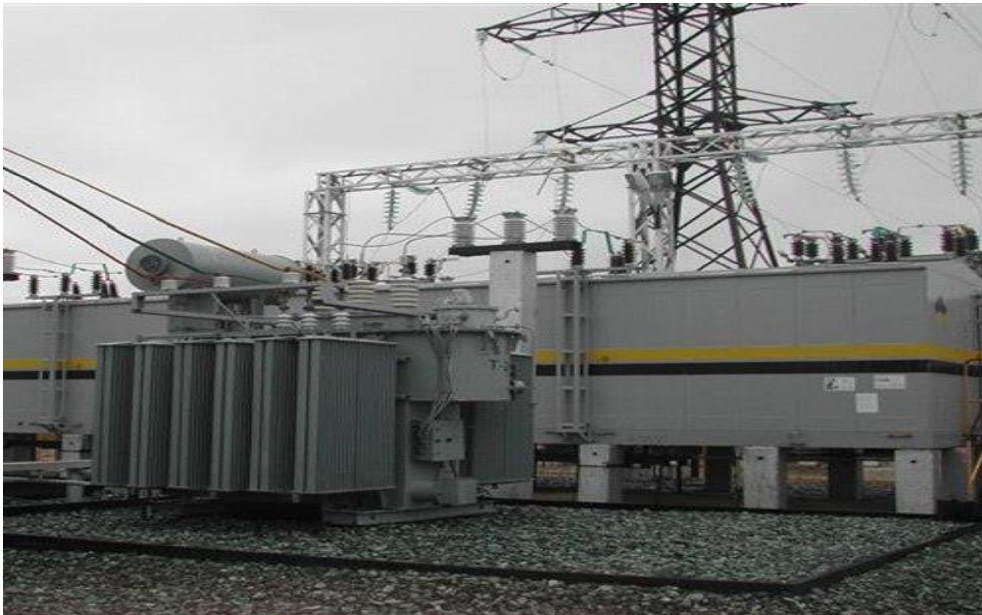
Kuchlanishi 500/220/35 kV li podstansiyaning umumiy ko'rinishi
