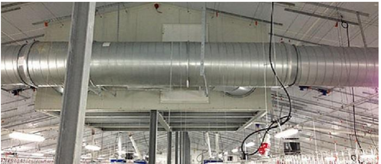
40 rasm. Konditsioner tizimining havo kanallari.
