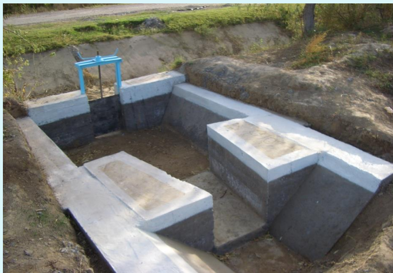
Водомерный лоток САНИИРИ (ВЛС)
