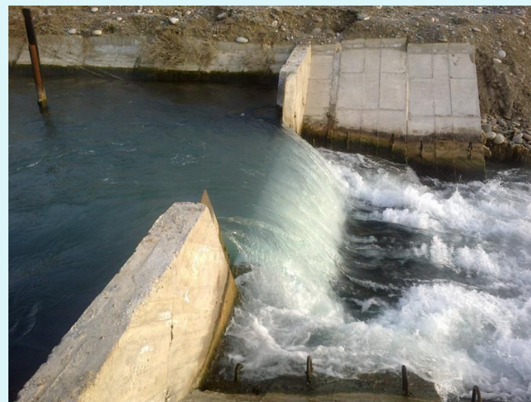
Процесс использования водослива с пропускной способностью около 10 м³/с .
