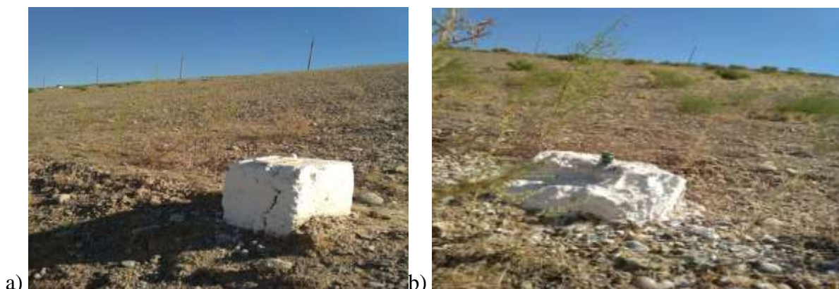
3-rasm: To'g'on tanasiga o'rnatilgan betonli markada aniqlangan nuqsonlar
