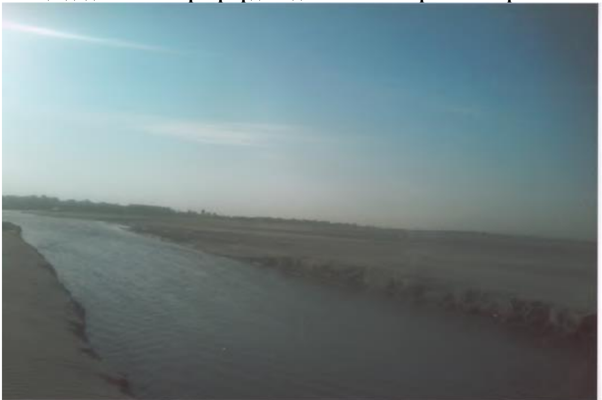
3.5-расм. Шихжамол насос станциясига сув келтирувчи каналнинг казиш ишлари олиб борилгандан кейинги ҳолати
