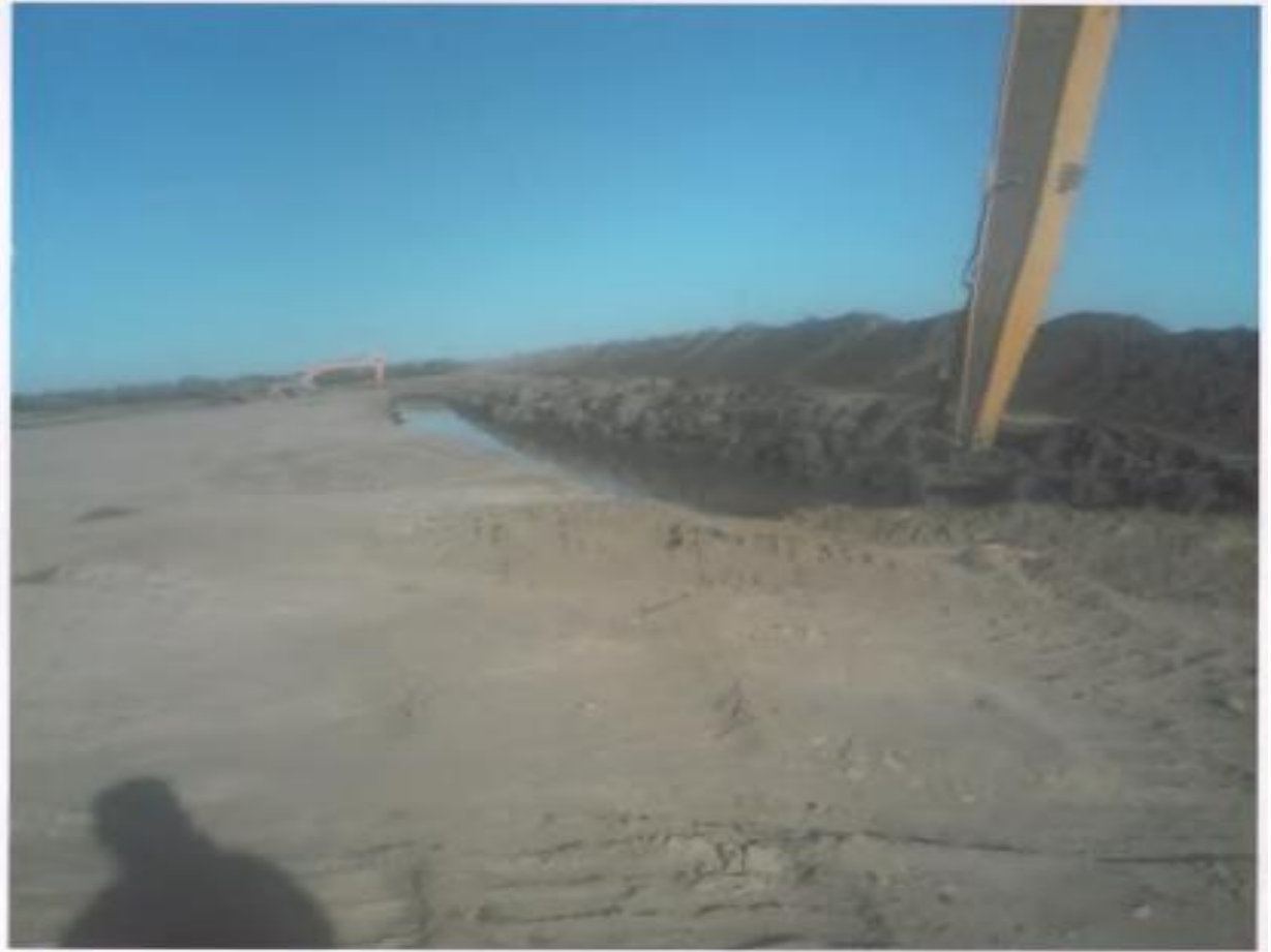
3.4-расм. Шихжамол насос станциясига сув келтириш мақсадида экскаваторлар ёрдамида казиш ишлари олиб борилаёпти
