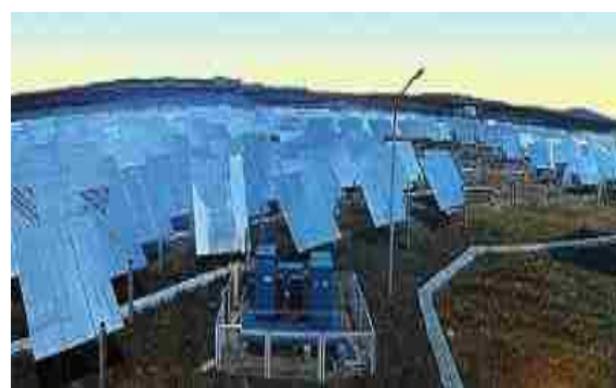
2.4-rasm. Qrim quyosh elektr stansiyasi. (Yassiquyosh batarealari)
