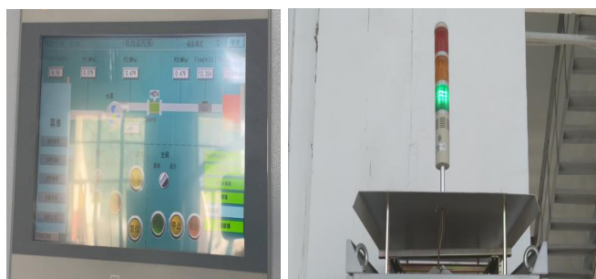
Рис.7. Монитор для диагностики параметров насоса и сигнальный шкаф с трехцветным контролером состояния насосного агрегата.
