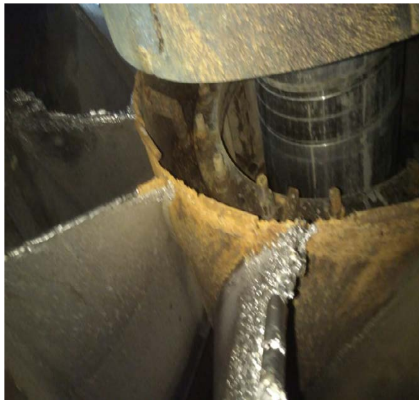
Дефектация рабочего колеса
