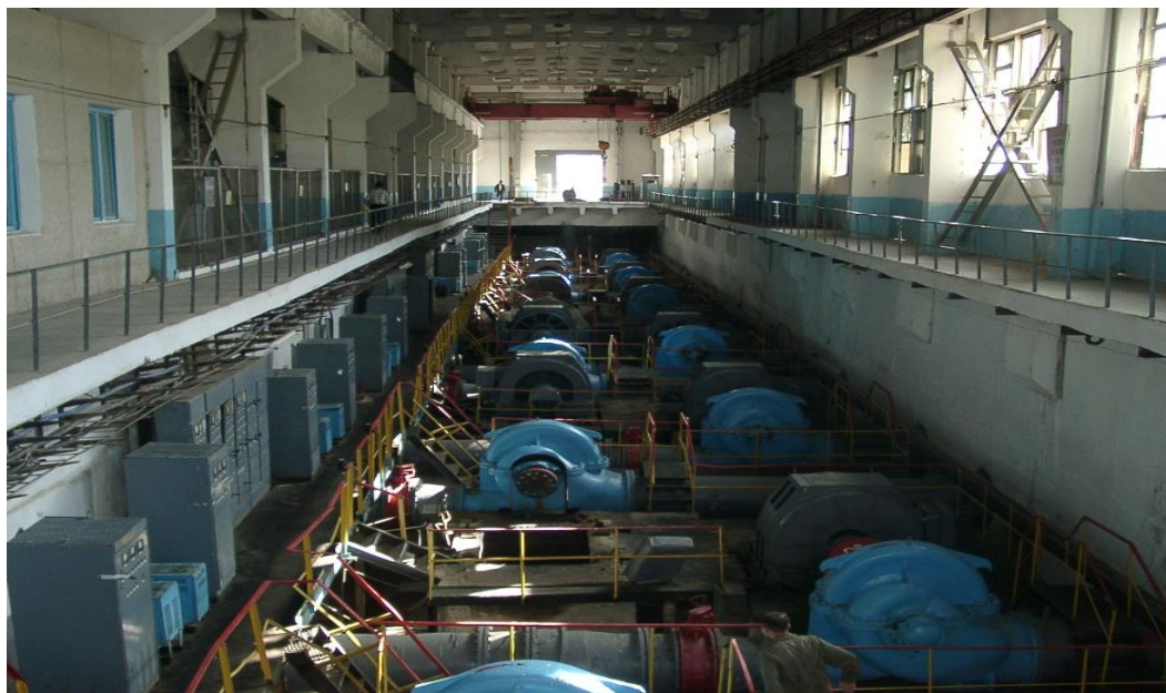
Рис.5.14. Общий вид машинного зала № 1
