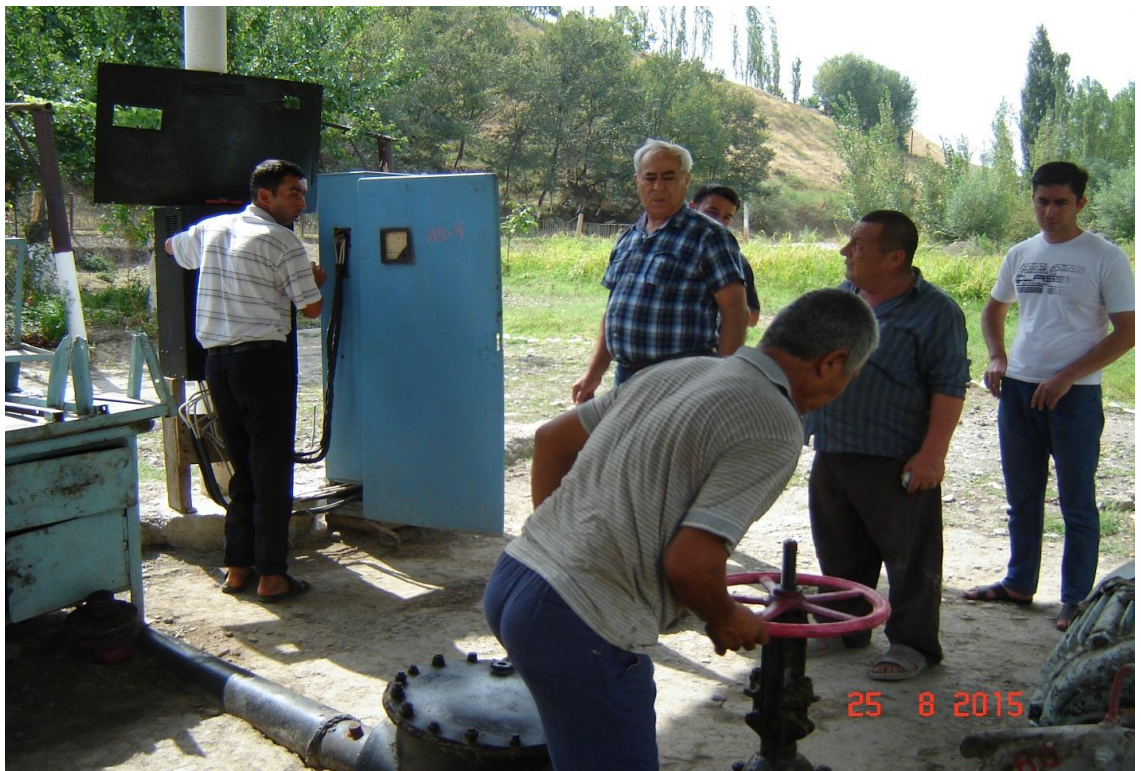
Рис.3.23. Запуск насосного агрегата
