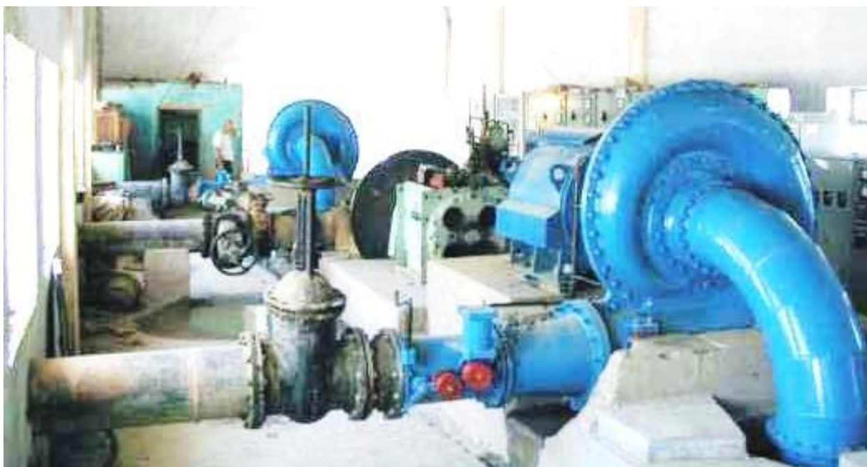
106-rasm. Gorizontal radial-o'qiy turbinalar o'rnatilgan kichik GES binosining ko'rinishi.
